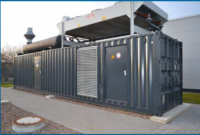
Zwei Dieselaggregate stellen einen unterbrechungsfreien Betrieb sicher
