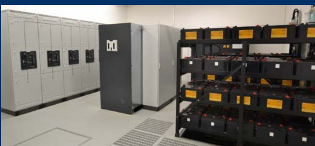
Blick in den Technikbereich
