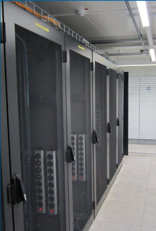
Klimazellen gewährleisten optimale Temperaturverhältnisse im Rechenzentrum
