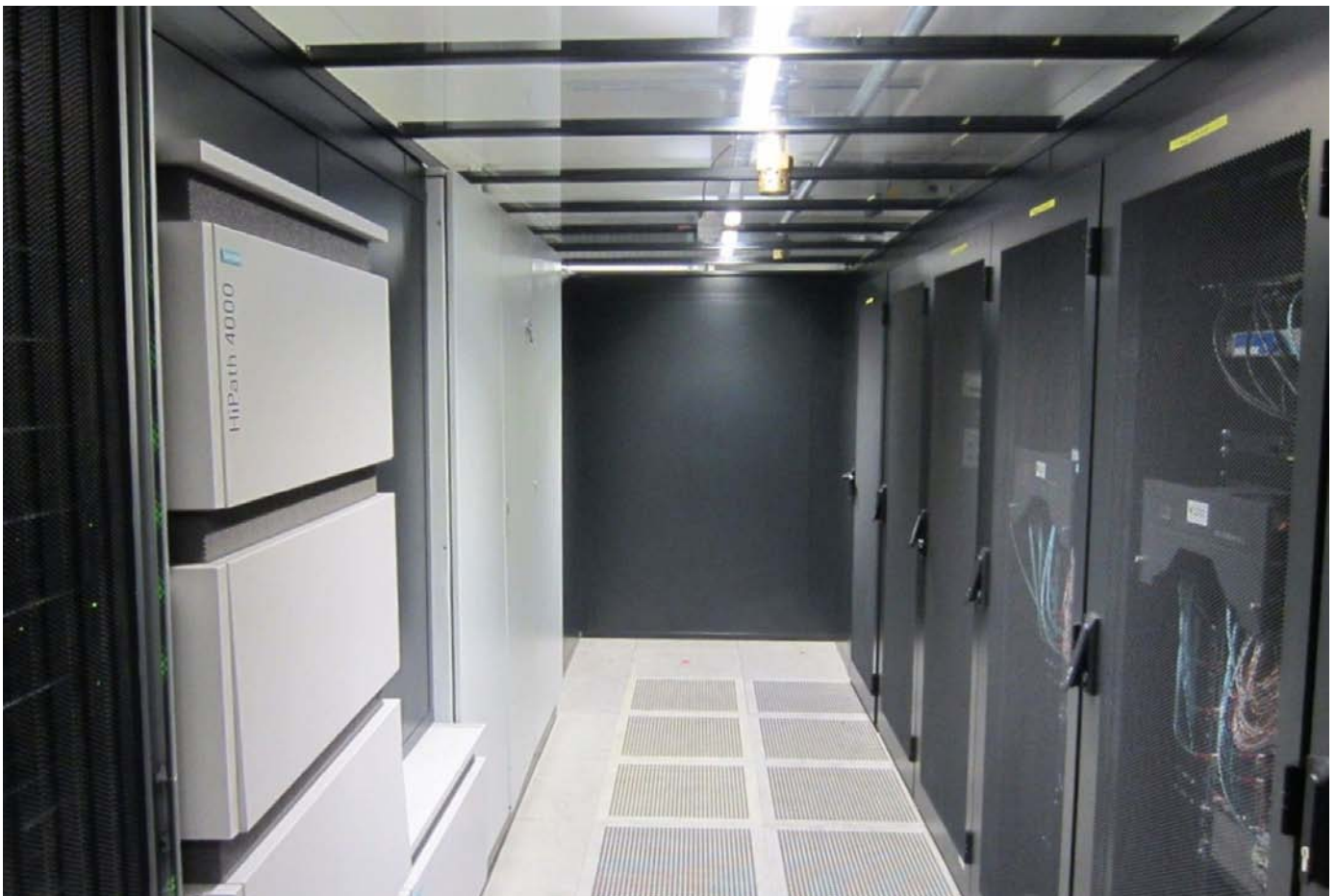
Kaltgangeinhausung bei Vallourec & Mannesmann
